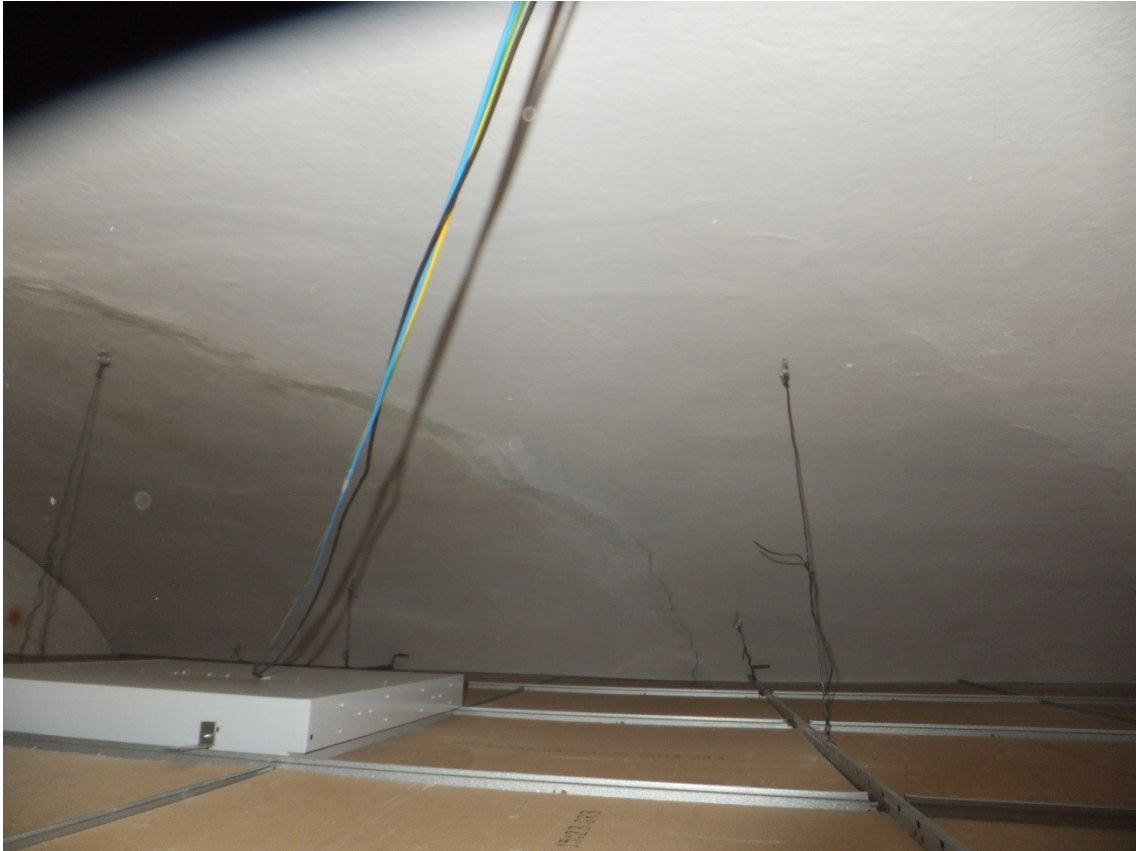
Fotografia 7 – Vista su fessurazioni volta copertura sede Alpini al primo piano
