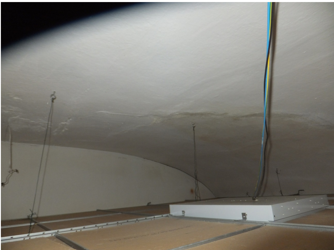
Fotografia 8 - Vista su fessurazioni volta copertura sede Alpini al primo piano
