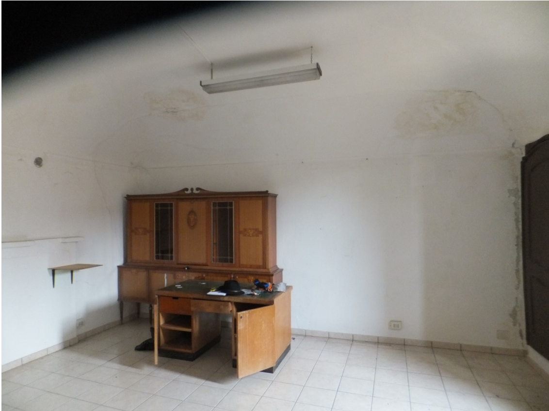
Fotografia 5 – Vista su fessurazioni localizzate sgombero al primo piano
