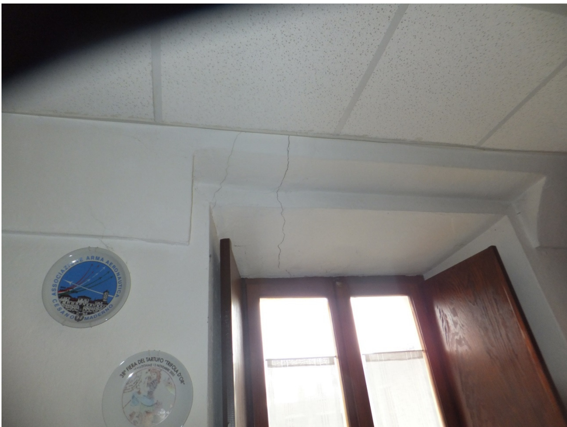
Fotografia 6 – Vista su fessurazioni vicino finestra sede Alpini al primo piano
